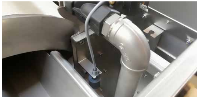
Montage Schwimmerschalter 1 im rechten Bereich der Vorkammer unter dem Magnetventil
